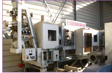
Bild 4: Indirekt elektrisch beheizter Drehrohrofen der zur Verfügung stehenden Technikumsanlage
