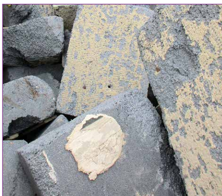
Bild 6: Putz und Kleberreste am Dämmstoff
