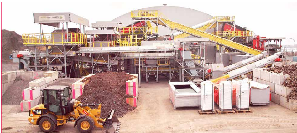
Bild 3: MV-Schlackenaufbereitungsanlage der Firma Tartech in Wiesbaden
