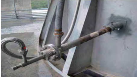
Bild 5: Zuleitung von Ammoniakwasser zu einer von vielen SNCR-Düsen zur Entstickung
