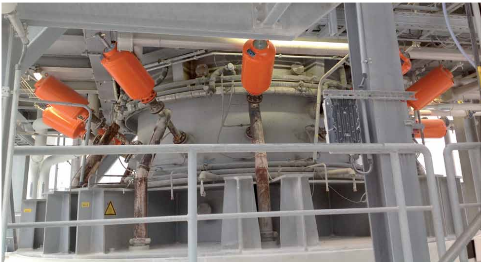
Bild 12: Luftkanonen im Bereich der Kühlluftabführung
