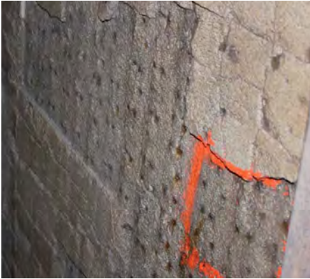
Bild 1: Betonabplatzung durch Alkaliangriff
