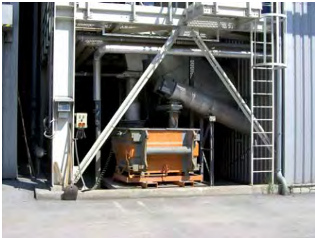
Bild 4: Kesselaschetransportcontainer TBA Arnoldstein (A)
