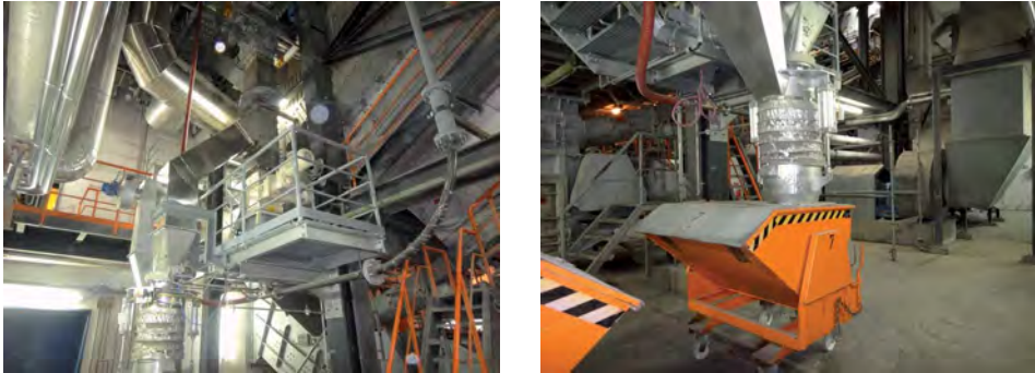
Bild 6: Ascheschacht mit Weiche / Kippcontainer (Not-Entaschung) MHKW Coburg (DE)
