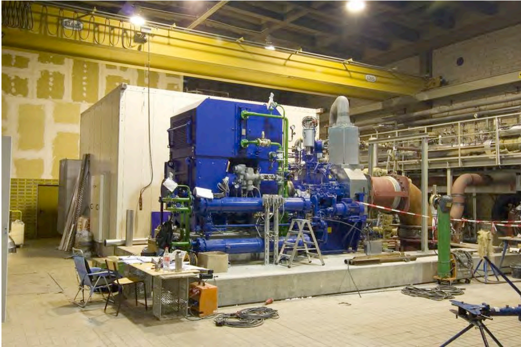
Bild 5: Dampfturbine zur Stromerzeugung im Klärwerk Ruhleben
