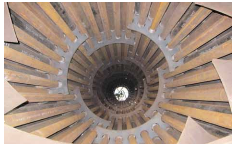
Bild 10: Blick in einen der beiden Rohrbündeldrehrohr Trockner
