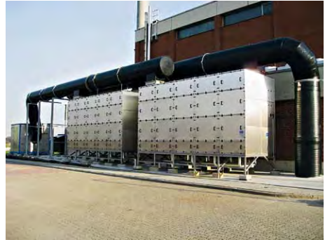
Bild 6: Abluftanlage Zentralkläranlage, Werkbild Neutralox Umwelttechnik GmbH
