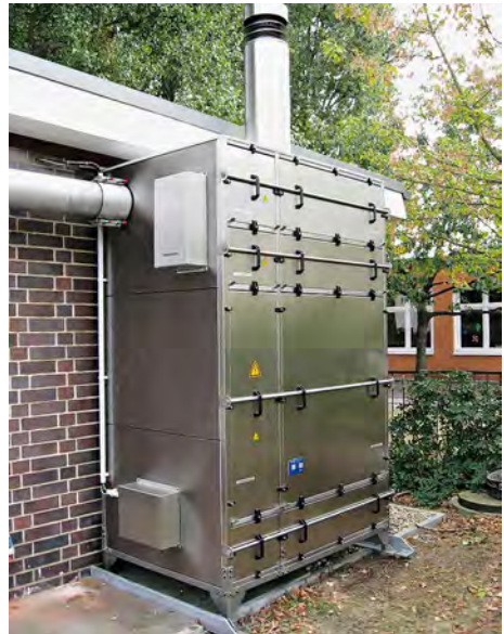
Bild 5: Abluftanlage für 800 m 3 /h Abluft aus einer Abwasserpumpstation
